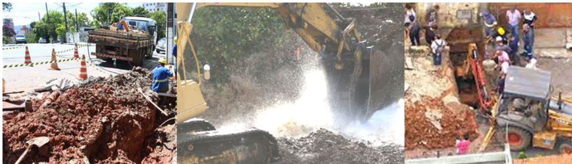
Figura 1: Sinistro e escavações “a maior” devido ao desconhecimento da localização da rede.
